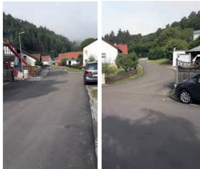
In Bach a. d. Donau sind Teilbereiche der Asphaltdeckschichten des Waldweges und des Fichtenweges saniert worden. Schächte und Schieber wurden erneuert bzw. angehoben, Grundstückszufahrten und Randbereiche angeglichen.
